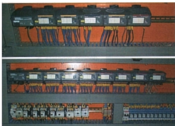
Figura 3 : Vista dei moduli FieldPoint
